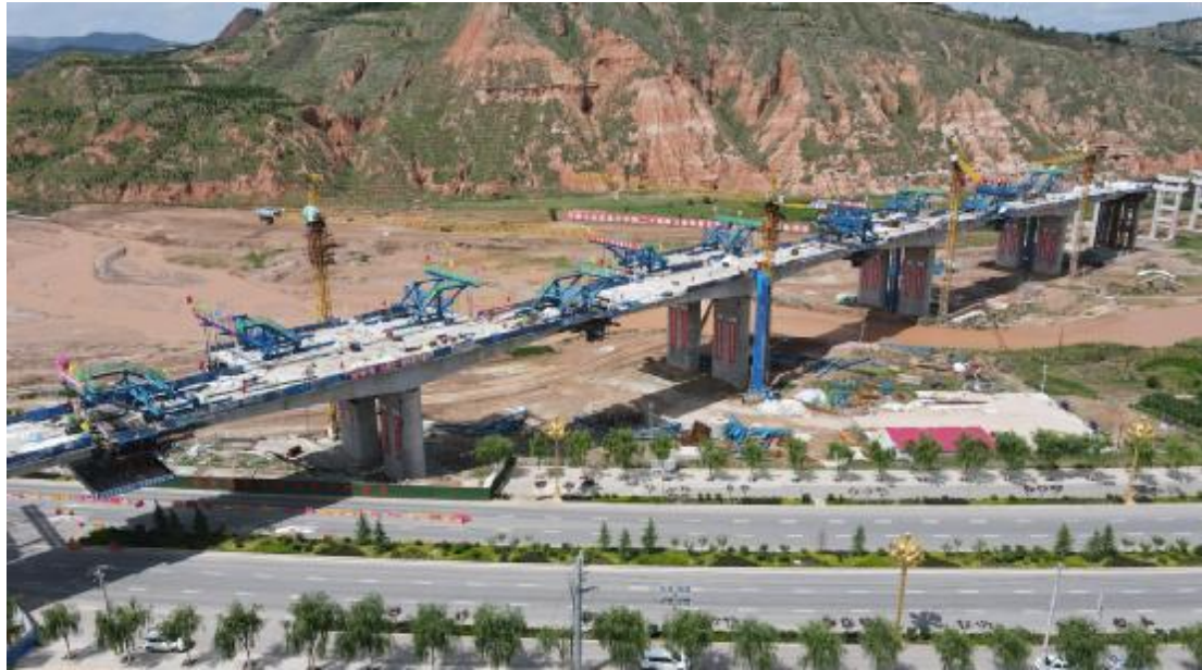
8月8日凌晨4时,由六公司承建的甘肃首座公路转体桥——陇漳高速公路渭河特大桥悬浇梁左幅全部合龙,该桥全长2782.92米,主跨跨度为80米,桥面宽度为25.5米,其上结构采用装配式预制梁和悬浇梁方式施工。目前,该桥右幅悬浇梁正在抓紧施工中,预计将在10月下旬实现全部合龙。图为施工中的陇漳高速公路渭河特大桥。 高佩强摄
