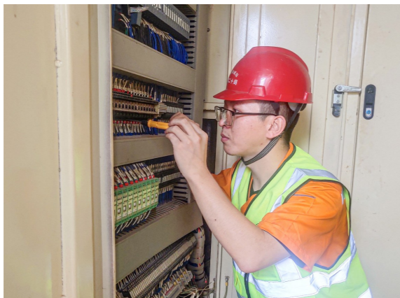
图为马生周正在检查盾构机控制柜继电器。赵勇摄
