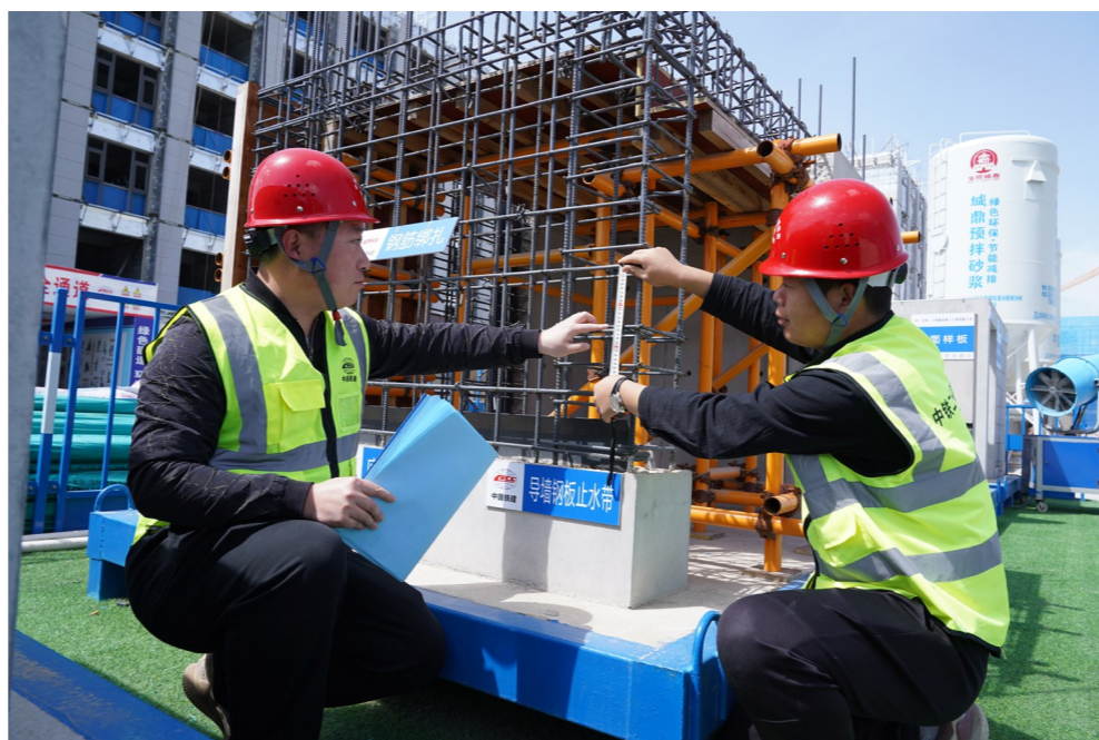
近日,六公司延安会议中心综合体工程项目部通过组织学习工程样板间工艺工法,采用“专职安全员+智能设备监控”等方式,紧抓关键环节,紧盯重点区域,以确保市政府“家门口”工程安全、质量一次成优。图为六公司先进职工李明洁(左)利用午休时间为新员工张鹏(右)现场讲解施工技术要点。陶柯宇 摄
