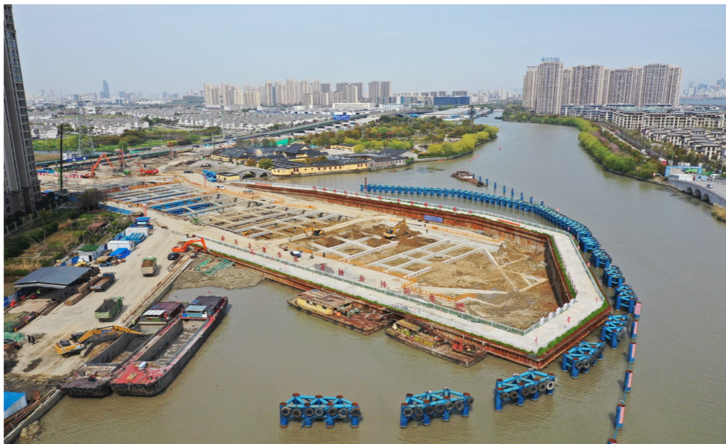
一公司承建的苏州独墅湖第二通道工程，是苏州国际物流快速通道项目的重要组成部分，是苏州市投资规模最大的道路交通工程。上场以来，该项目团队采用科技手段防治噪音、粉尘污染，得到了建设单位和当地群众的一致好评。图为苏州独墅湖第二通道工程。 谢建辉 摄
