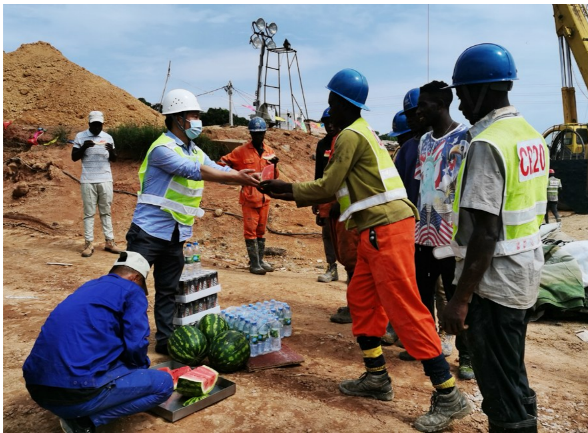
入冬的祖国，天寒地冻，而遥远的西非，骄阳似火。在中铁二十局安哥拉国际公司承建的安哥拉南部高原万博省卡鲁巴度桥施工现场，40多名中安方员工头顶烈日，脚踏钢筋，已连续奋战数十日。目前，卡鲁巴度桥主体工程已全部完工。图为安哥拉国际公司为现场全体员工送去西瓜、饮料等防暑降温慰问品。 斯琴 摄
