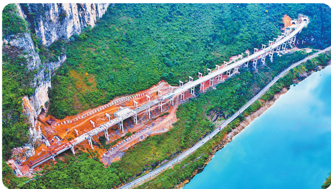
日前,随着最后一根长30米、重80吨的预制T梁安全、平稳就位,三公司施工的渝湘高速复线彭(水)酉(阳)路杨家大桥右幅T梁架设全部完成。至此,实现了标段内单幅贯通,打通了全线运输堵点,大大缩短了全标段运距。施工中,项目建设团队超前谋划,制定科学合理施工计划,加大资源投入,强化节点考核,最终提前完成节点目标计划。图为杨家大桥施工现场。
